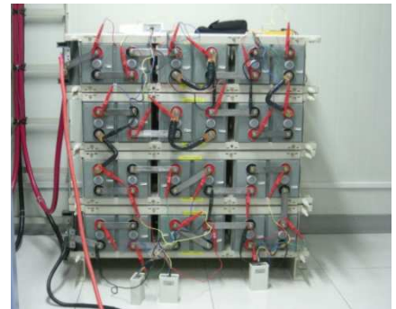
Bild 1: Beispiel für den Aufwand eines Entladeaufbaus
